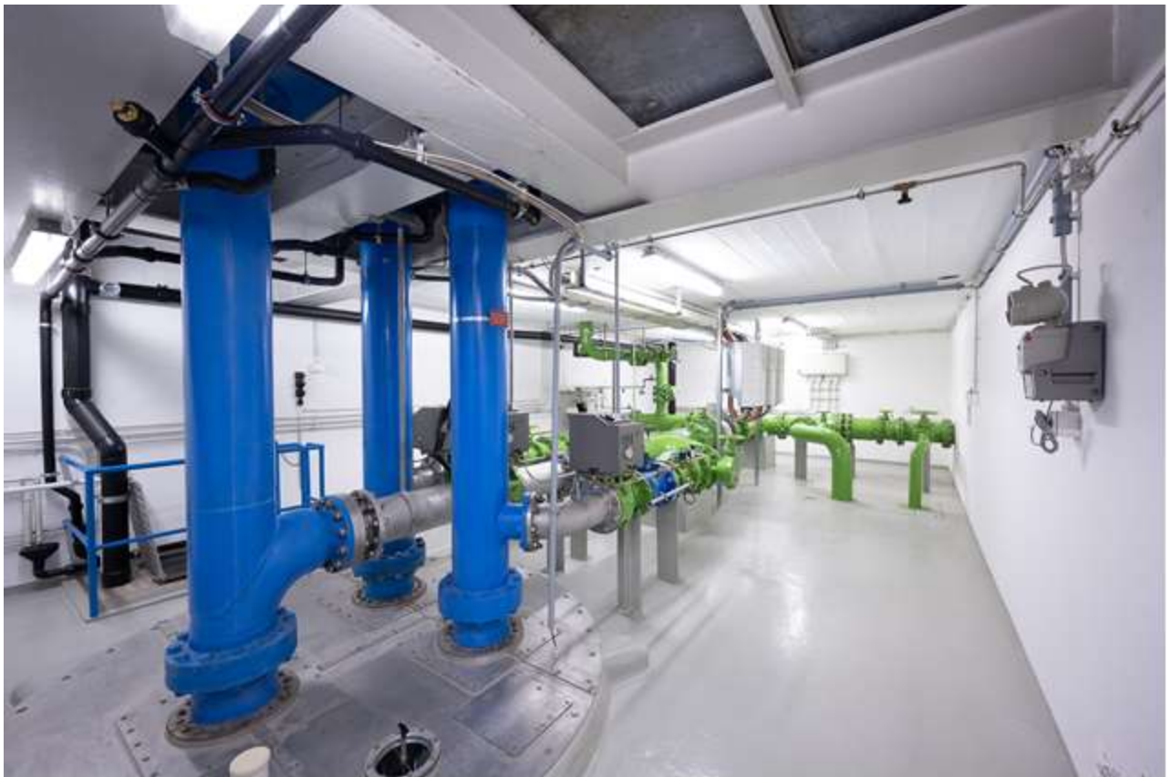
Bild: Grundwasserpumpwerk Thal
