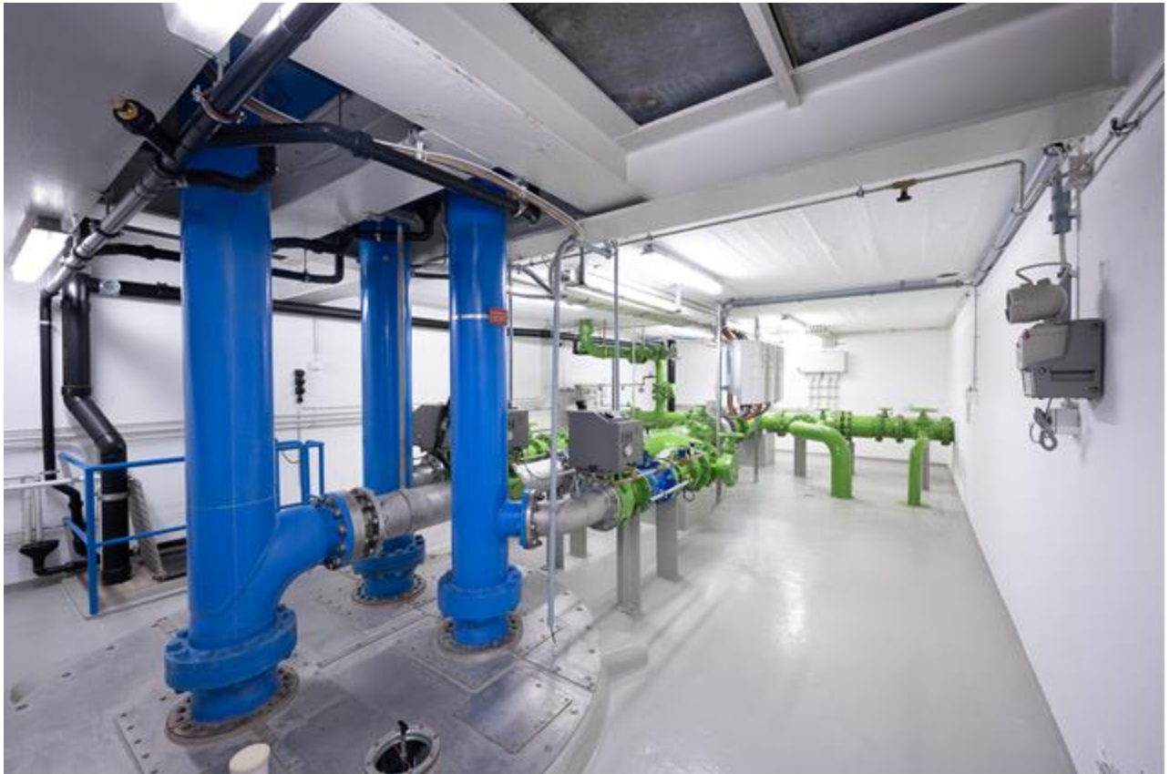
Bild: Grundwasserpumpwerk Thal
