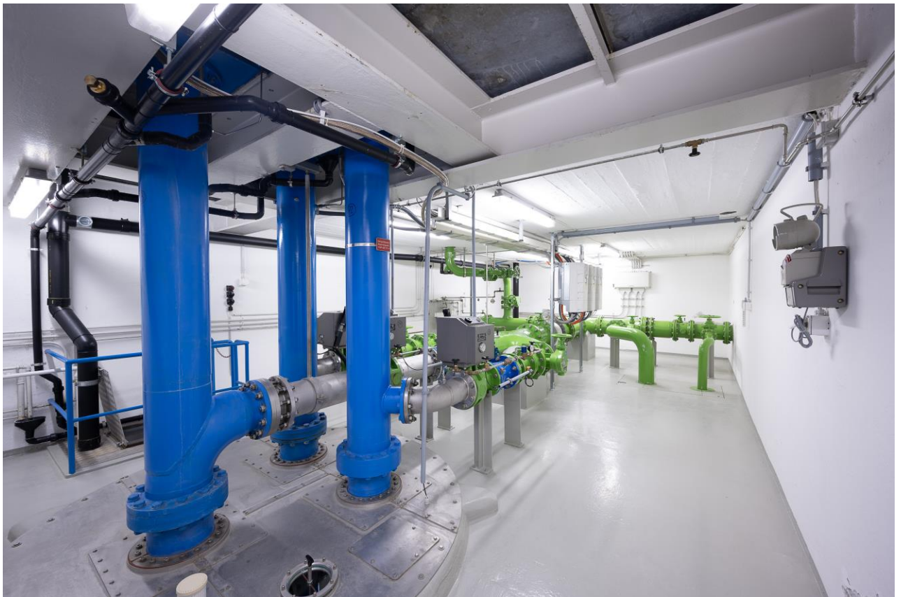
Bild: Grundwasserpumpwerk Thal
