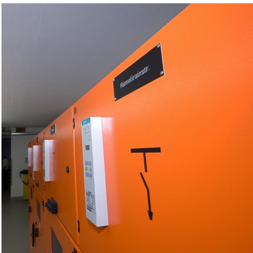
Bild: Schalter in Trafostation
