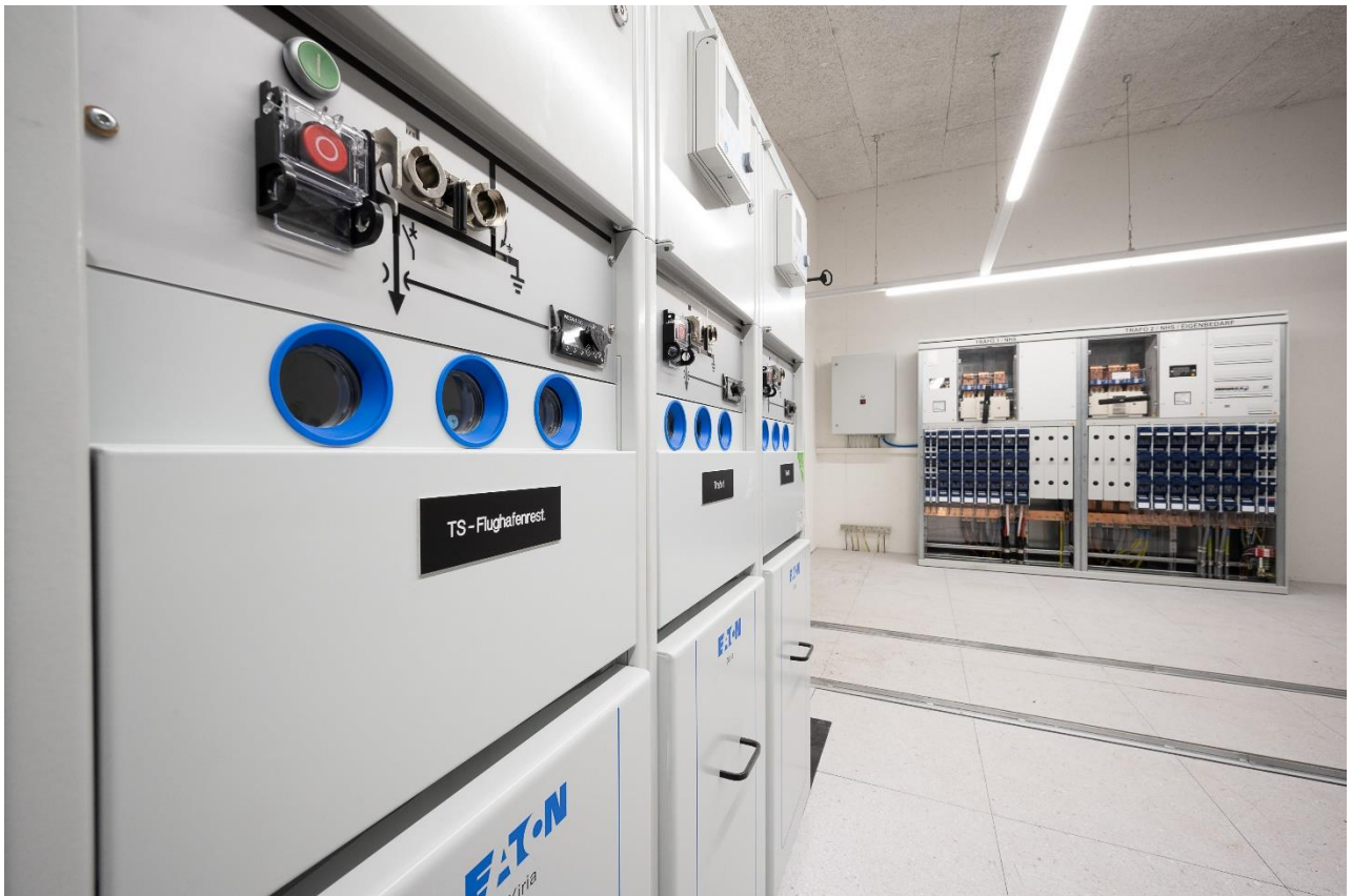
Bild: Trafostation im Flughafen
