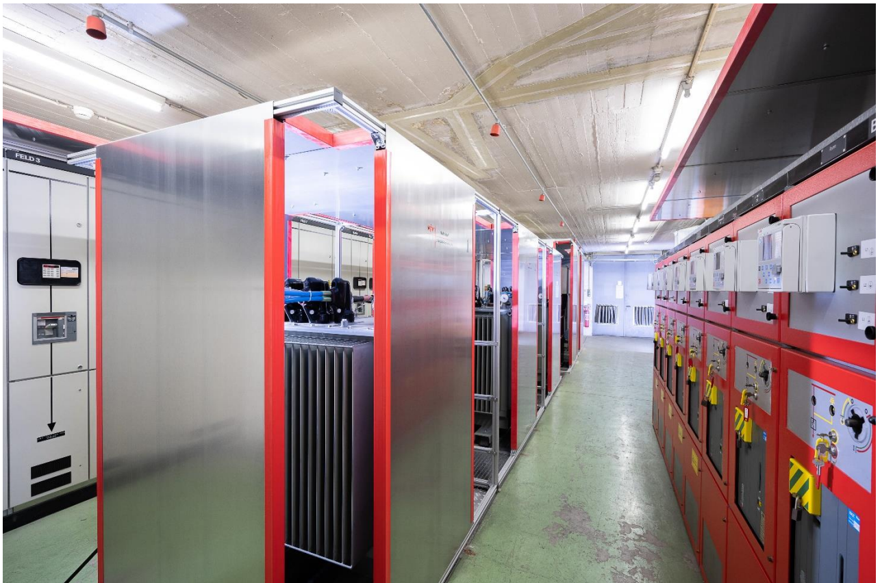
Bild: Mittelspannungs Anlage, Trafostation Flughafen
