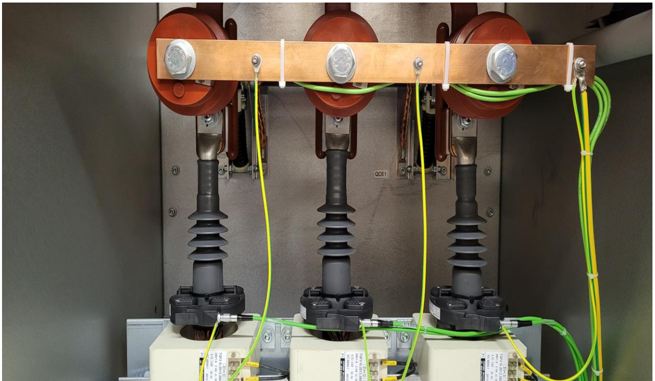
Bild: Erdschlussfassung, TS Schützenmatt
