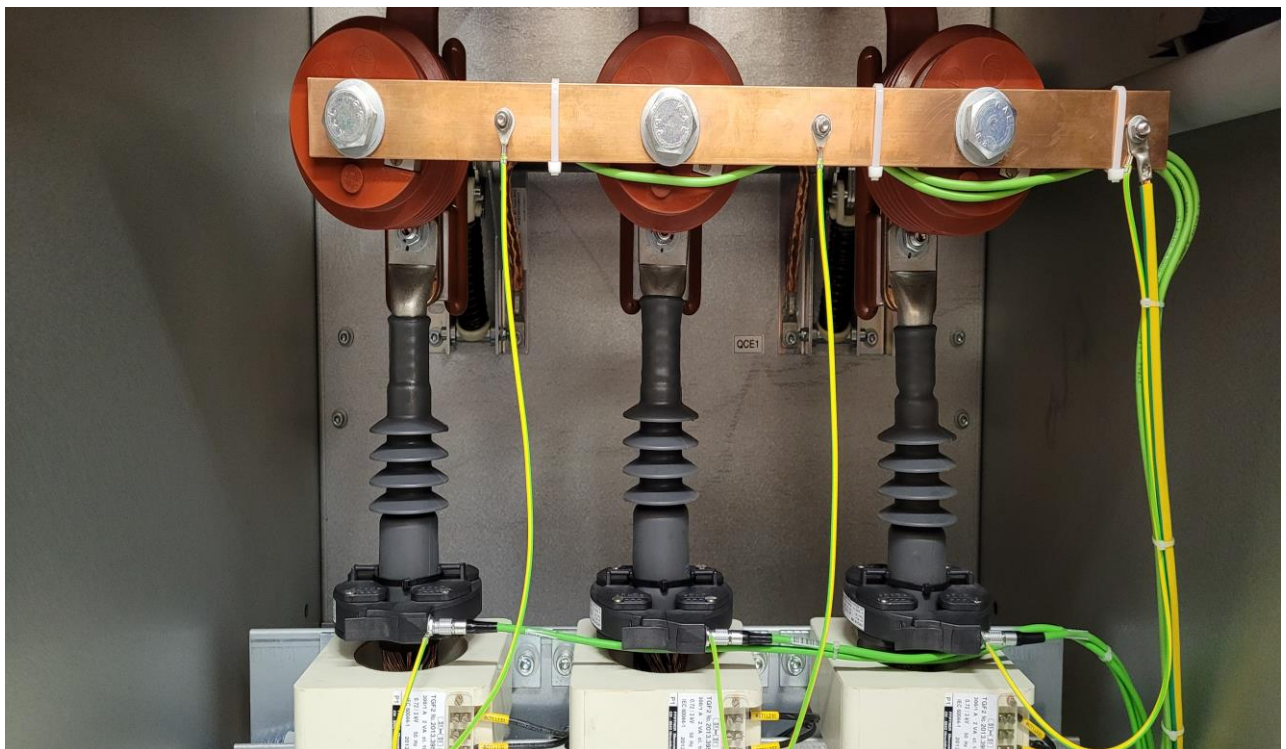
Bild: Erdschlussfassung, TS Schützenmatt
