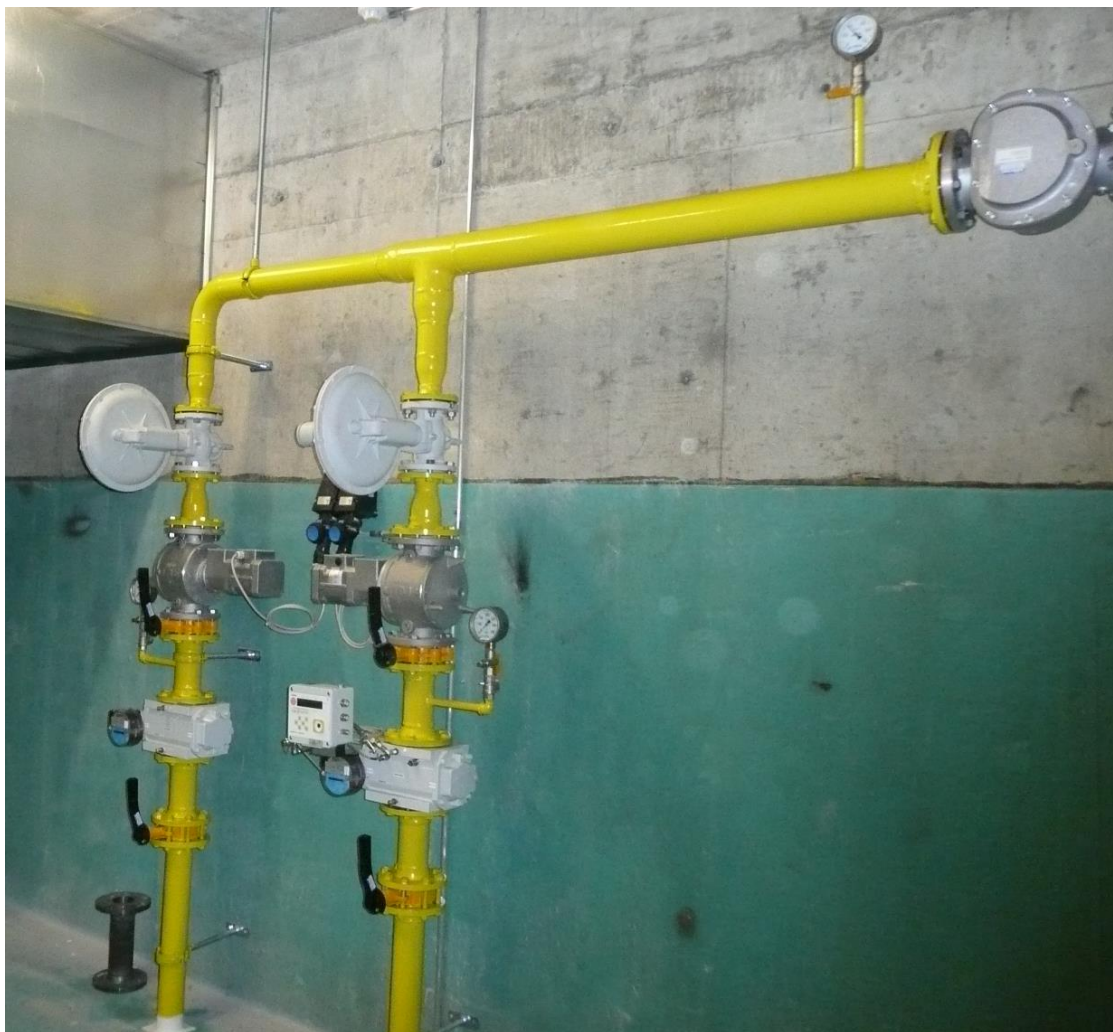
Bild: Gas-Strasse zu Heizung und BHKW
