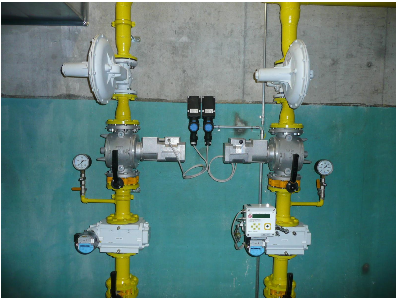
Bild: Gas-Strasse zu Heizung und BHKW
