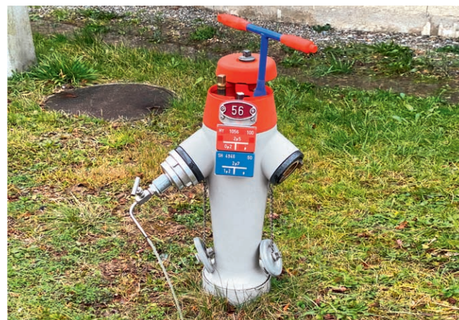
Wasserprobe ab Hydrant, Foto: ibk/Renato Compagnino
